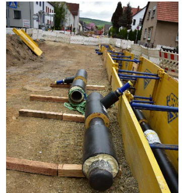
Vorgefertigte Formteile am Rohrgraben für das neue Fernwärmenetz in der Stadt Springe © Stadtwerke Springe
