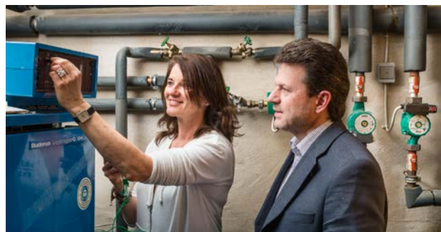
Clever-heizen Energieberatung vor Ort, © Stefan Koch
