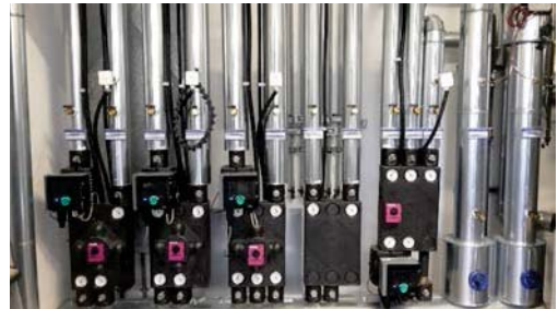
Ein hocheffizienter Heizungsverteiler in der Sporthalle © Landkreis Schaumburg
