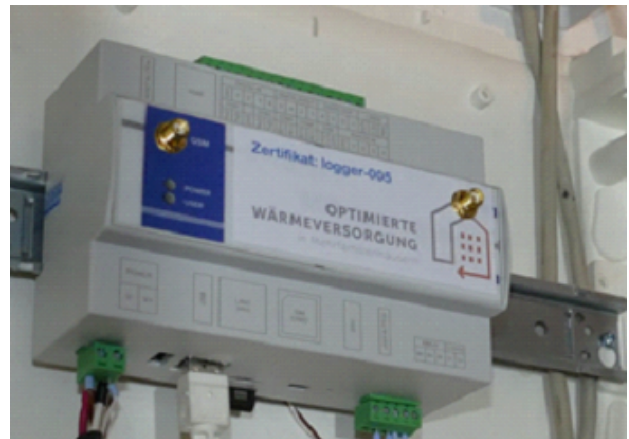
Ein Datenlogger, eingebaut in einem Heizkeller. Der Logger wird über die Internet-Verbindung konfiguriert.
