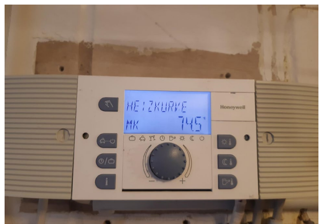
Foto der digitalen Regelung einer Heizungsanlage, die Heizkurven sind in diesem Fall in der Betriebsanleitung abgebildet (4)
