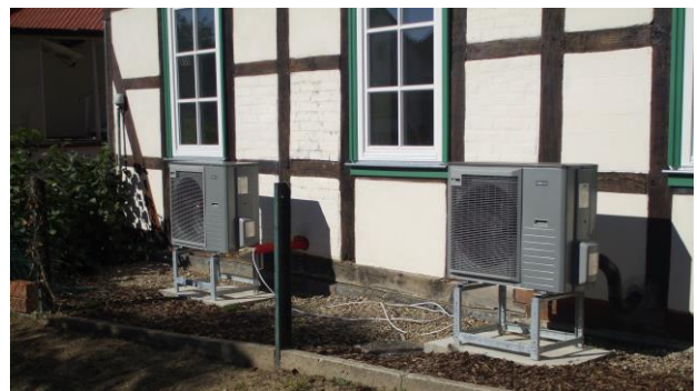
Wärmepumpe zur dezentralen Versorgung © Energieberatung Thomas
