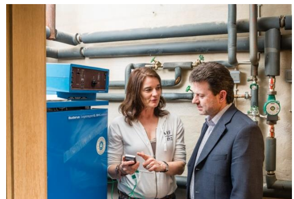
Bestandsaufnahme: Eine qualifizierte Energieberatung bietet einen Überblick über den Zustand des Gebäudes und die Handlungsmöglichkeiten. Foto: Stefan Koch
