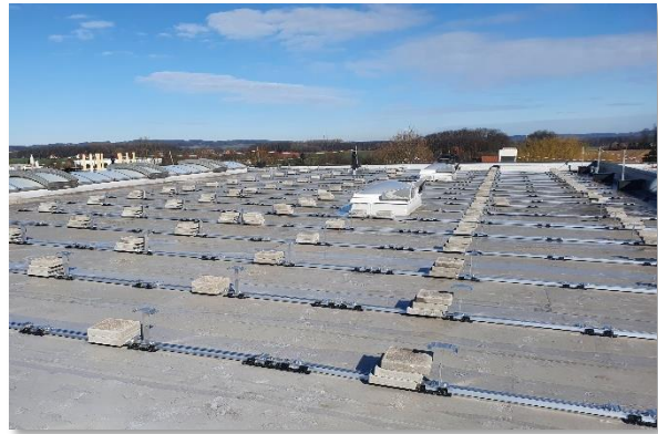
Das Dach der Flex-Punkt Druckformen GmbH vor der Installation der PV-Module © C. Mücke
