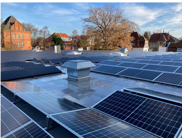
PV-Bestandsanlagen aus dem Jahr 2009, Foto: KEAN
