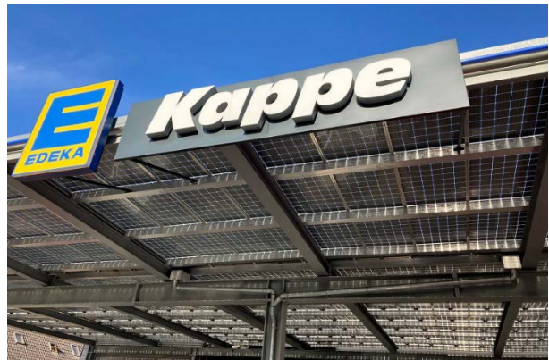
Parkflächen-PV-Anlagen aus dem Jahr 2018, Foto: KEAN
