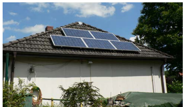
PV-Anlage auf dem Dach
