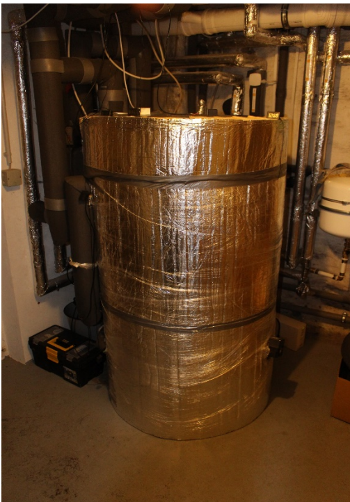
Speicher mit alukaschierter Glaswolle im Keller
