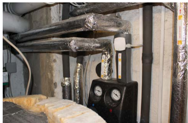
Keine „indirekte Kellerbeheizung“ - alles ist fachmännisch gedämmt
