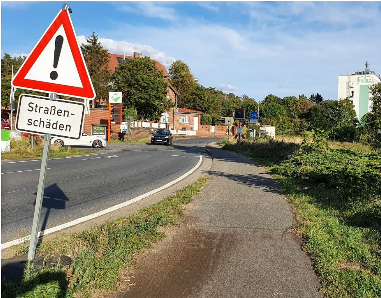
Abb. 13: Kein sicheres Radwegende des gem. Geh-/Radweges in der Kurve am Bahnübergang (Blickrichtung Stadteinwärts)
