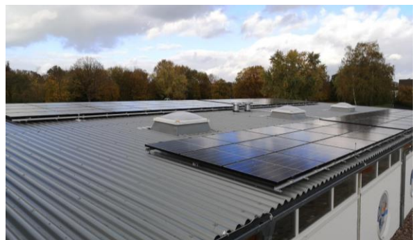
Auch das Freibad im Flecken Aerzen hat eine PV-Anlage auf dem Dach. ©Flecken Aerzen
