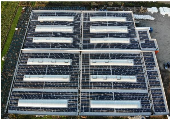
Mehr als 2000 Solarmodule wurden auf dem Firmendach der Ressel GmbH installiert. © M. Puchta
