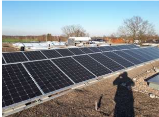
Die 9,6 kWp PV-Anlage sorgt auf dem Dach der Kita für erneuerbaren Strom © Frank Pjede, Ingenieurbüro Enerpe
