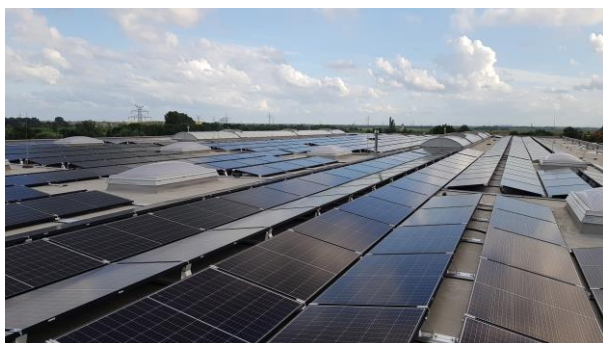
Die PV-Anlagen auf dem Dach sollen insbesondere den eigenen Strombedarf decken. © Hammerlit GmbH
