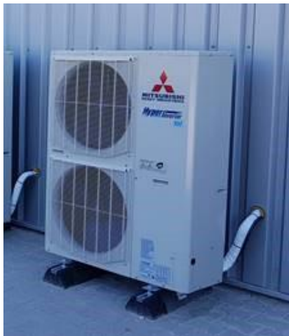
Die Wärmeversorgung wurde weitestgehend auf Wärmepumpen umgestellt © Hammerlit GmbH
