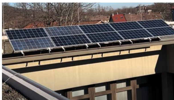
PV-Anlage der Adolf-Grimme-Gesamtschule Goslar
