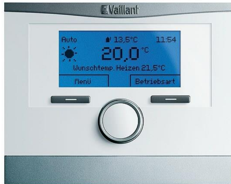
Fernbedienung: „Raum-Soll“ wirkt auf Heizkurven
