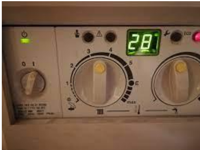
Handregler (alt) Quelle: heizungsforum.de
